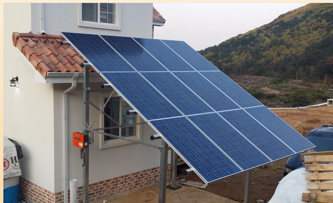
거제 펜션 주택용 태양광
