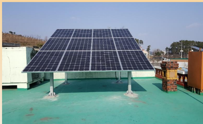
기장군 주택용 태양광
