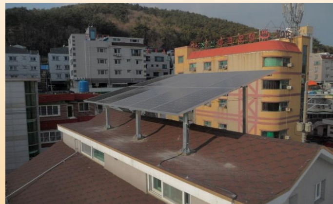
거제 서정리 주택용 태양광
