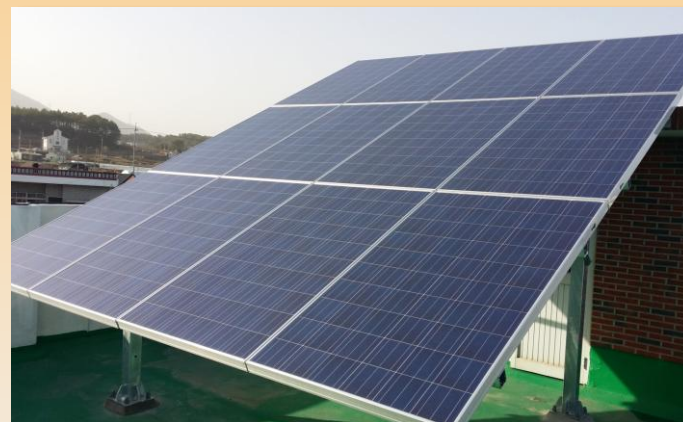
기장군 일광면 주택용 태양광
